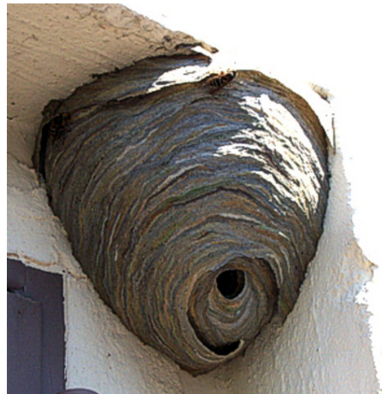
Abb. 3: Wespennest an einer Aussenfassade
